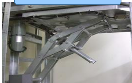
換気口浸水防止機
