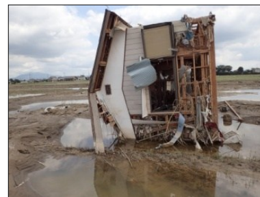
堤防決壊による家屋の倒壊
