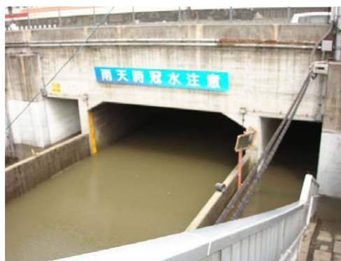
図 3-7 アンダーパス冠水の事例
